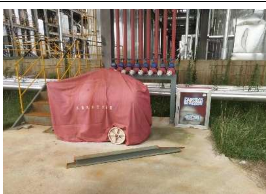
罐区外泡沫灭火装置
