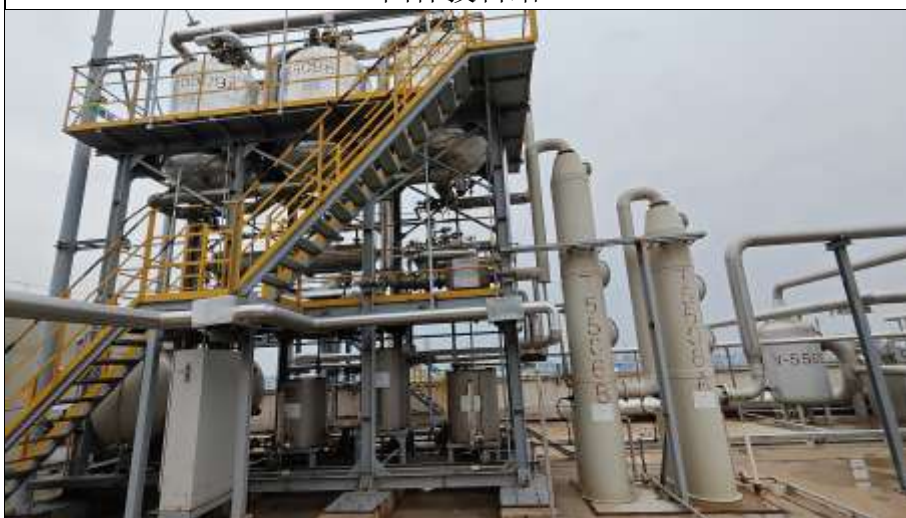
两级碱喷淋+树脂脱吸附（TA003）
