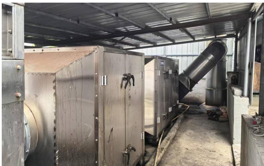
图 3-1 废气治理设施
