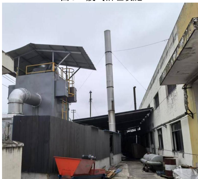
图 3-2 废气排放口（DA001）
