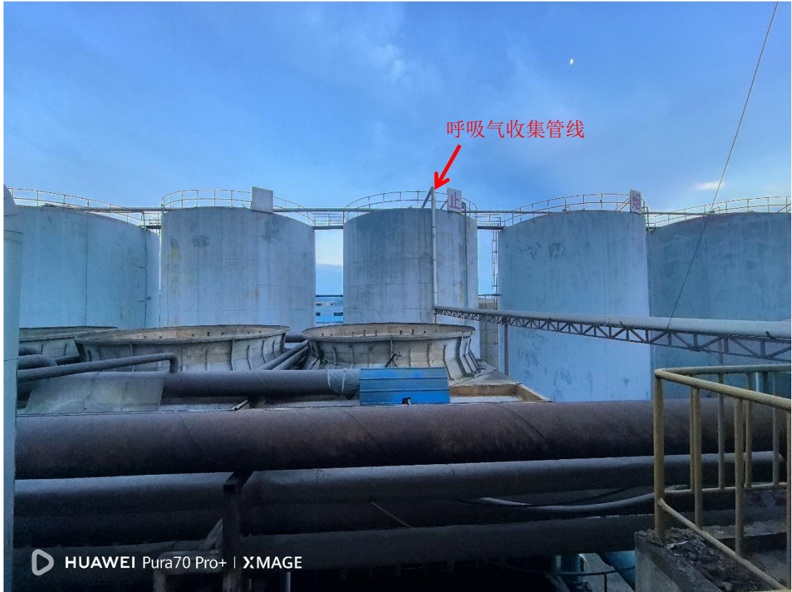
罐区废气收集管线
