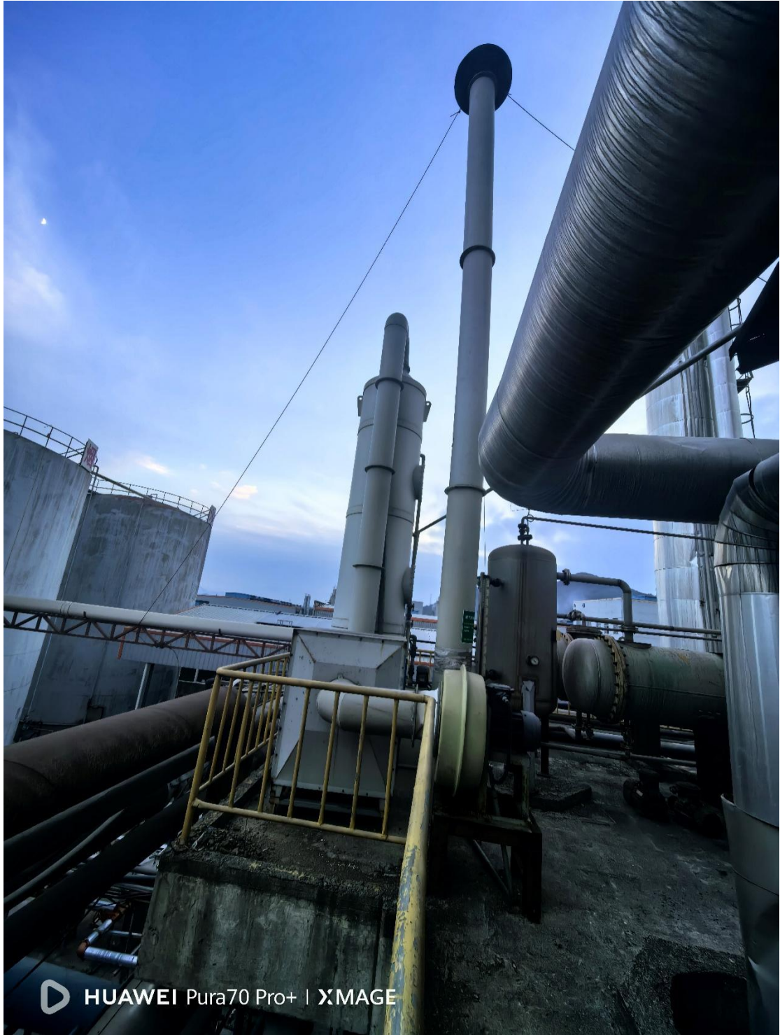
罐区废气水喷淋塔及排气筒 TA014 和 DA014
