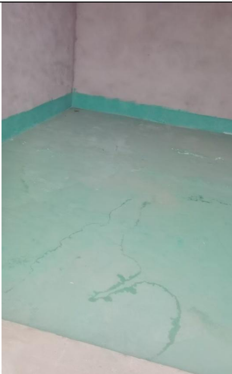
危废库内部（防渗地坪）
