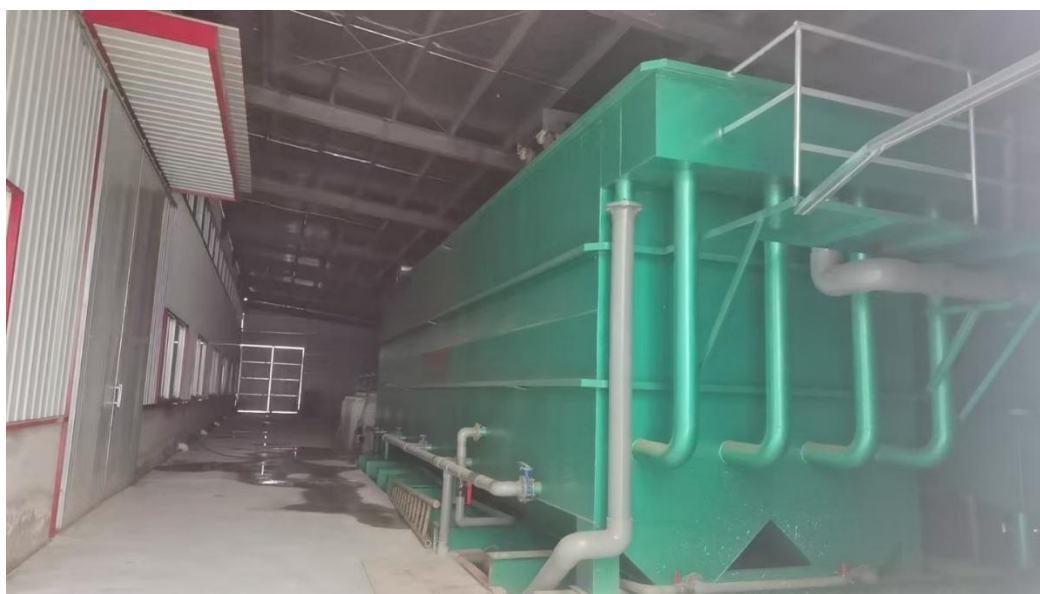
污水处理设施
