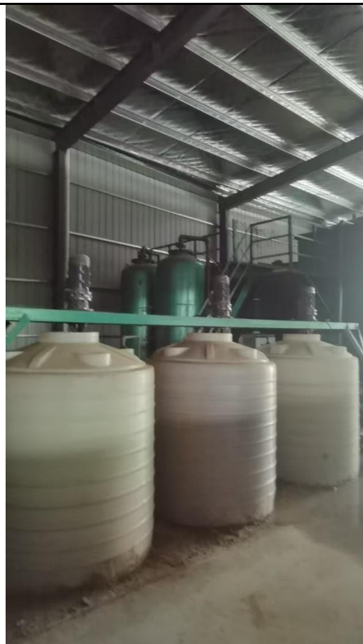
污水处理站内部
