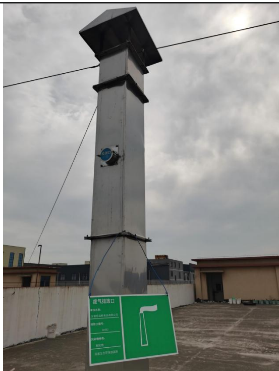
DA002 废气排放口
