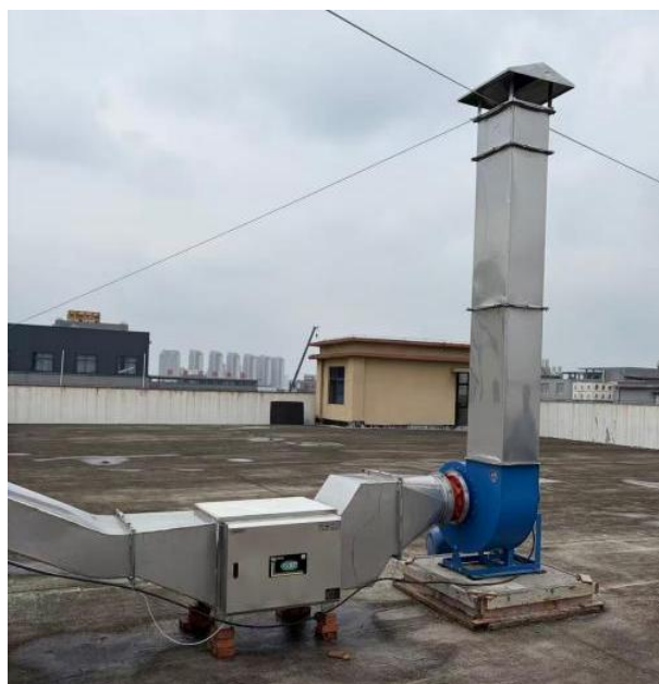
DA003 废气排放口
