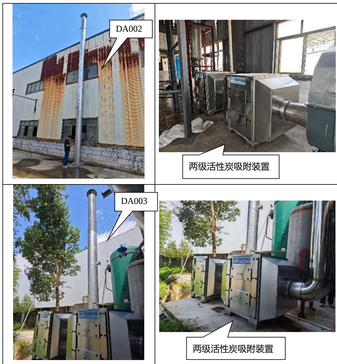
图 3-3 废气处理设施
